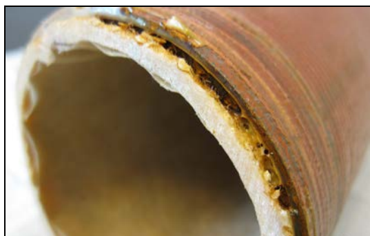
Fig. 31: Prøve I, etter prøving – korrosjon
