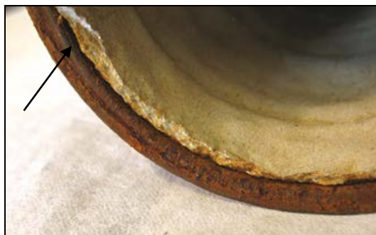
Fig. 33: Prøve II, etter prøving – løsnet reliningmateriale som er vasket bort
