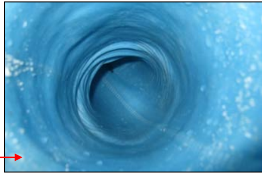
Fig. 54: Avløp til klosett sett ovenfra og ned i avløpsrør – kontroll utført i 2014 (anlegg ikke satt i drift ennå)
