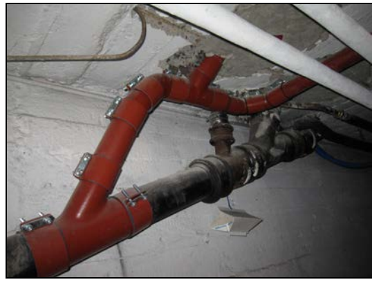
Fig. 82: Påkobling av nytt sluk i etterkant av rørføring. Opprinnelig støpejernsrør med svart utvendig belegg/maling har innvendig rørføring, mens nytt MA-rør med rødt utvendig belegg ikke har rørføring.
