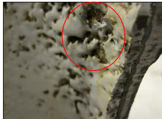
Fig. 58: Hull i belegg (sprøytemetoden) og korrosjon av opprinnelig støpejernsrør – kontroll utført i 2012
