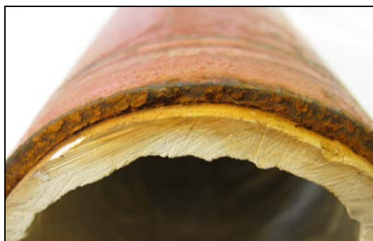
Fig. 32: Prøve II, etter prøving – korrosjon
