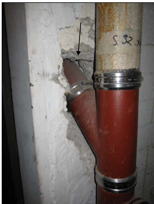
Fig. 83: Manglende branntetning mellom to brannceller i kjeller
